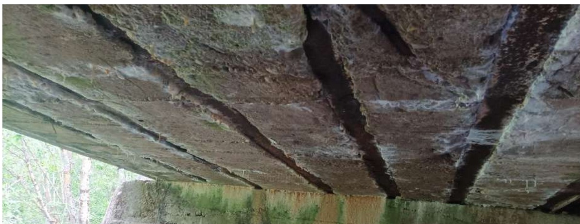
4 pav. Tilto perdangos kairiosios dalies būklė. Nekokybiškai įrengtas betonas, metalo korozija, matomi karbonatiniai produktai.
