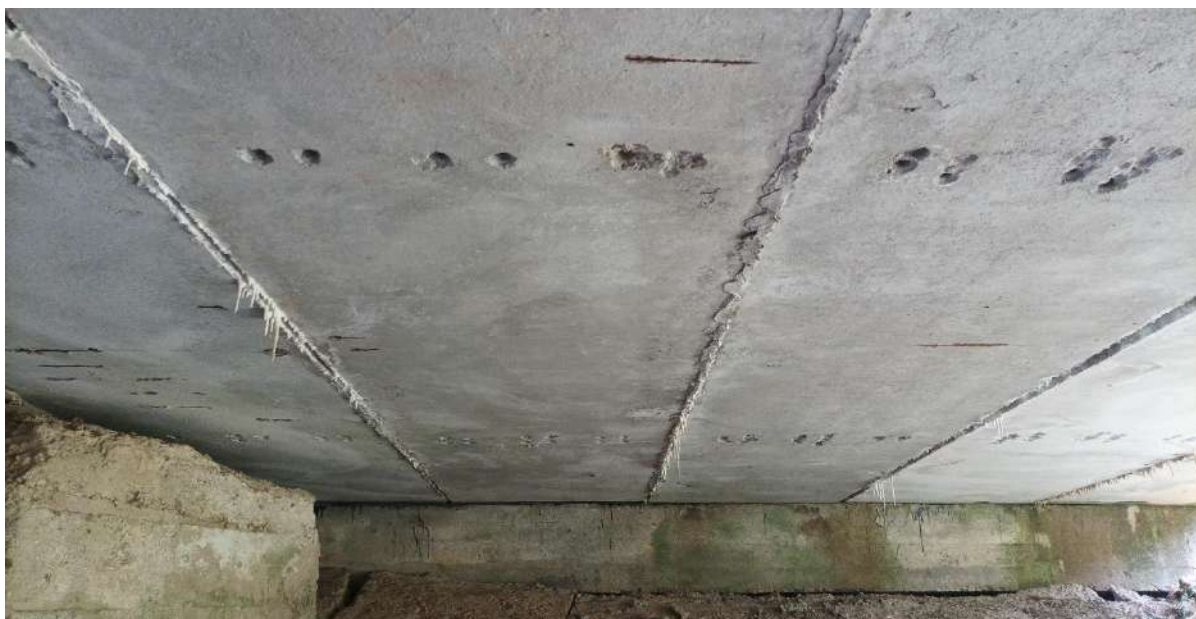
5 pav. Tilto perdangos dešinėsios dalies būklė. Matomi ištrupėjimai, neišlaikomas apsauginis betono sluoksnis, koroduoja armatūra. Matomi išsisunkę karbonatiniai produktai.
