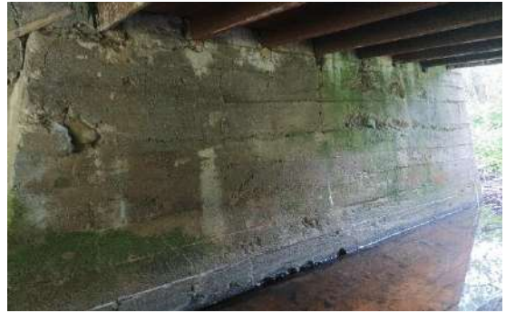
7 pav. Tilto tarpinės atramos kairiosios dalies būklė. Betonas ištrupėjęs, nesutankintas, užpildas per stambus. Matomi vertikalūs trūkiai.
