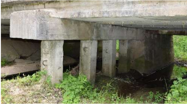
6 pav. Tilto tarpinės atramos dešinėsios dalies būklė. Matomi vandens nubėgimai.
