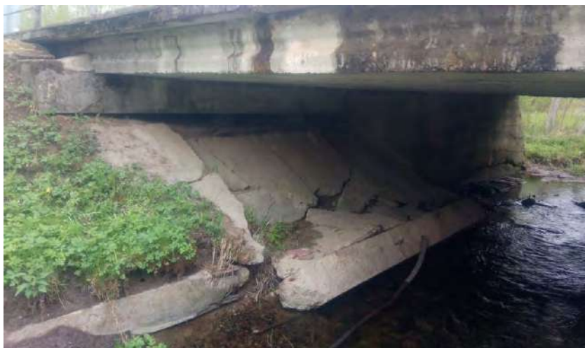
4 pav. Deformacija ties atramine sienelė
