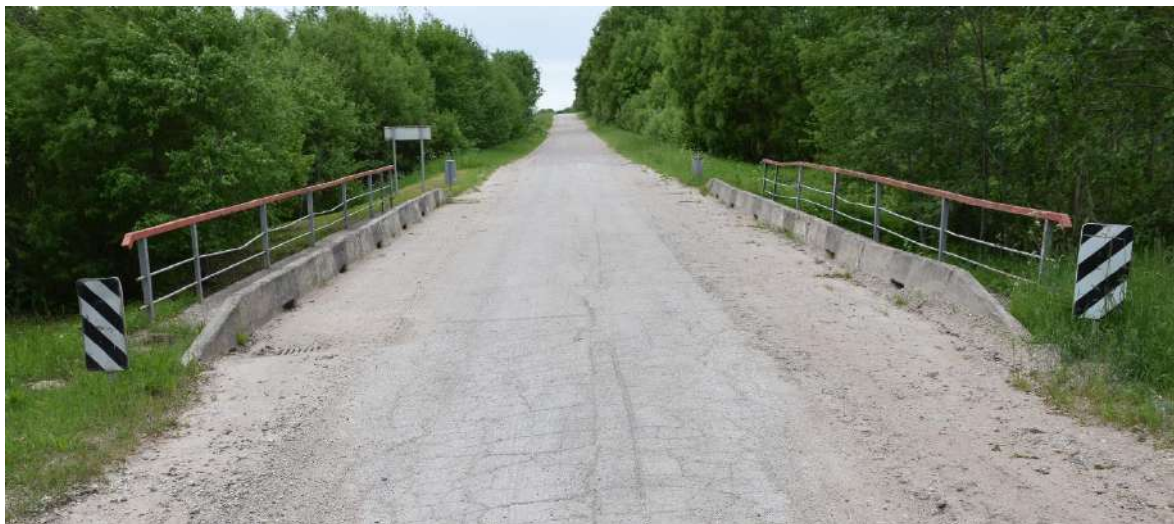
3 pav. Dangos ant tilto būklė. Danga supleišėjusi, užnešta žvyru, nelygi.
