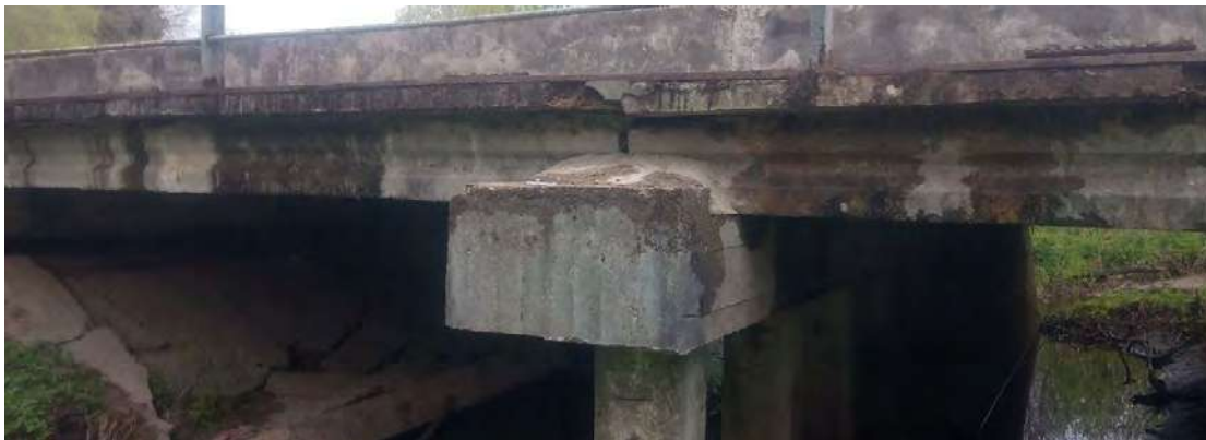
5 pav. Perdangos deformacija
